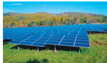
太陽光発電設備(当社設置太陽光パネル)
