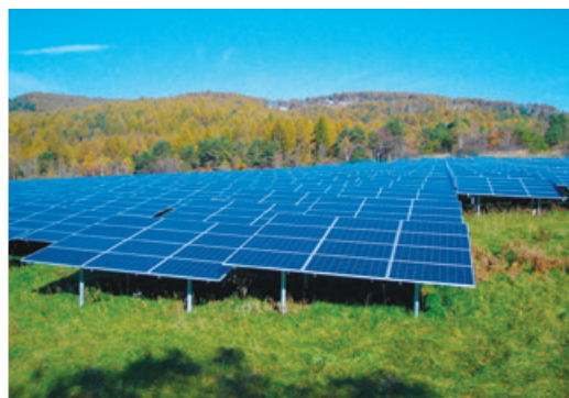
太陽光発電設備(当社設置太陽光パネル)
